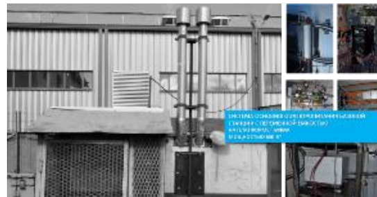
Система основного электропитания мощностью 600 Вт на платформе «Гамма» для базовой станции с переменной ёмкостью
