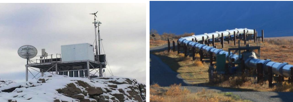
ЭУ 0,5 - 1,5 кВт «Аtrex» (США), в точке энергоснабжения автономного потребителя (слева) и на магистральном газопроводе (справа)
