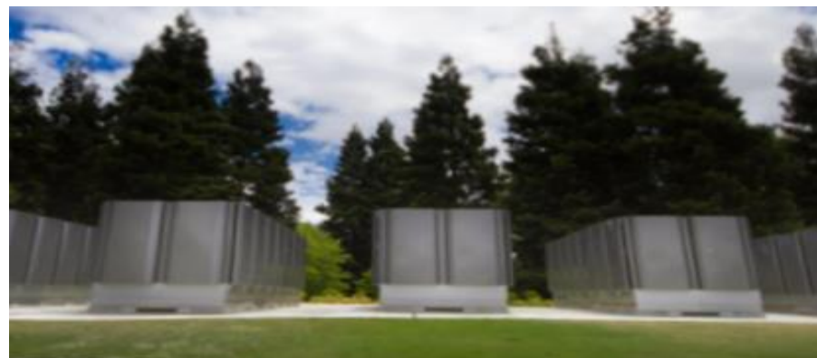
Электростанции мегаваттного класса из серверов 100 кВт «Bloom Energy» (США) на открытой площадке
