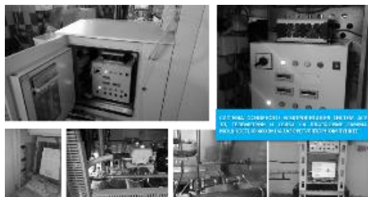
ЭУ основного электропитания мощностью 1,5 кВт на платформе «Гамма» для системы электрохимической защиты участка трубопровода
