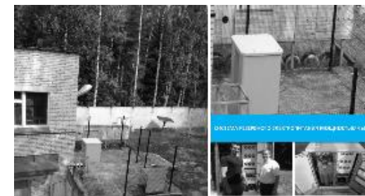
Система резервного электропитания мощностью 4 кВт
