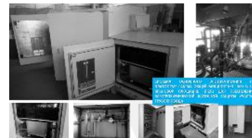
ЭУ основного электропитания мощностью 400 Вт на платформе «Гамма» для системы АСУ ТП, телеметрии и связи на газорегуляторном пункте
