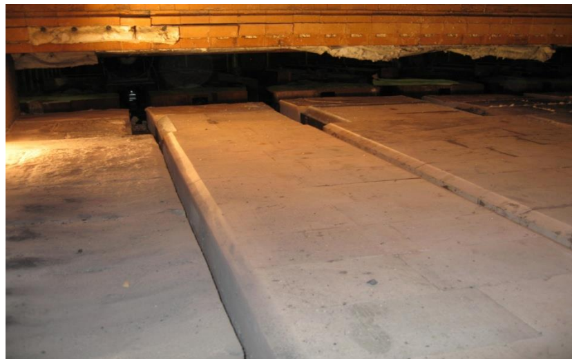
подина методической нагревательной печи Оскольского электрометаллургического комбината, РФ
