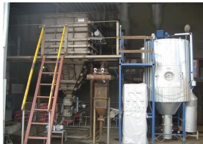
фильтровальная установка для очистки горячих газов
