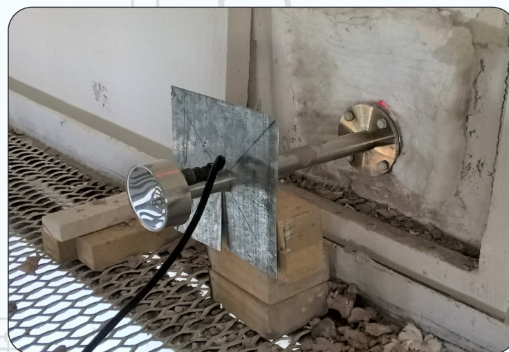
Датчик ЭКОН-ВТ, установленный в регенераторе стекловаренной печи
